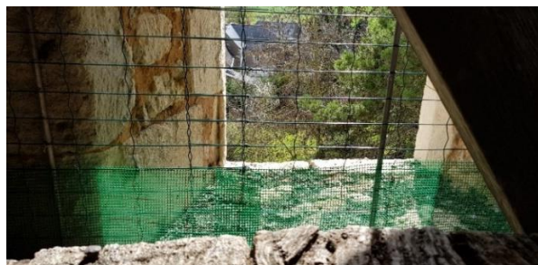
Figure 29. Exemple de grillage empêchant l'accès aux Pigeons bisets dans une église du Maine-et-Loire © J. Costa – CEN PACA
