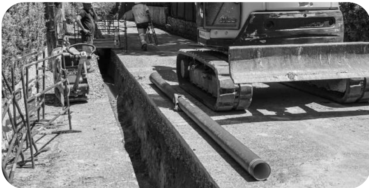
Renouvellement de 470 mètres de réseau AEP, chemin des Cassiers à La Roquette
