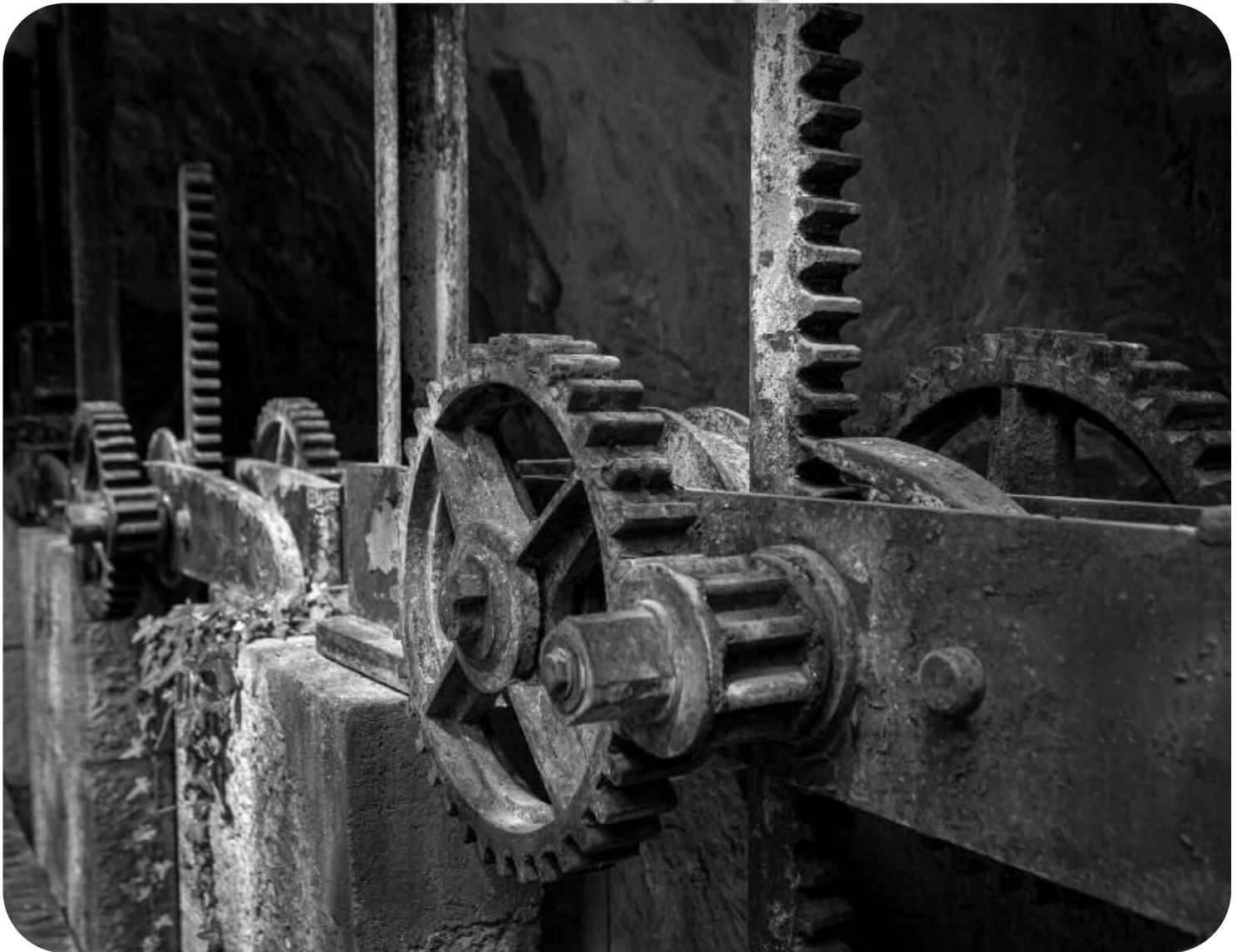
Crémaillères des vannes martelières de la prise d'eau du canal à St-Cézaire-sur-Siagne
