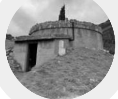
Réservoir Village (150 m³)
