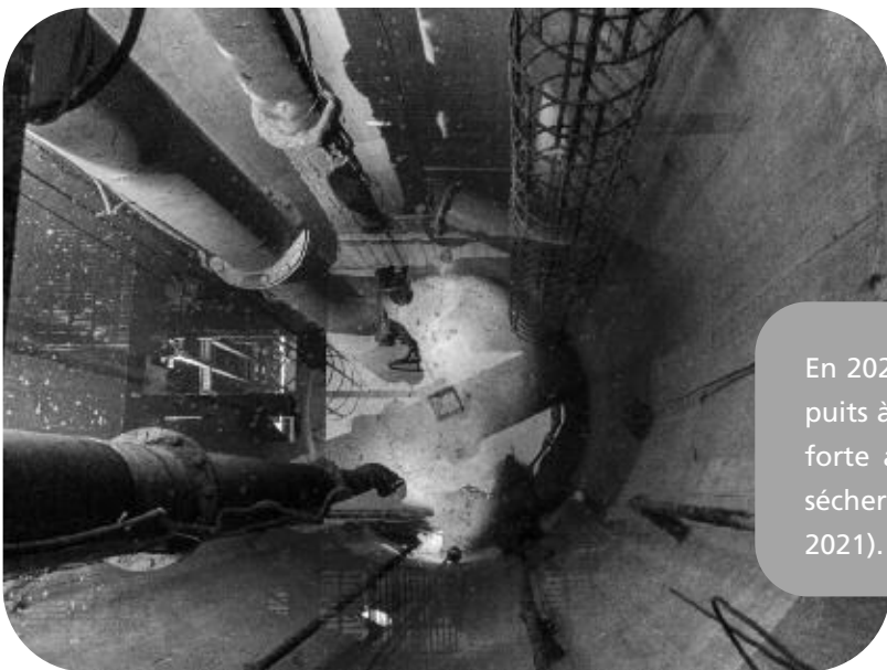
Puits à drains rayonnants
