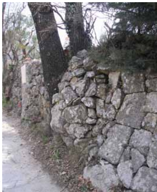
Dégradation du muret en pierres sèches par le chêne qui s'y est implanté. Marie Gautier, CRPF.
