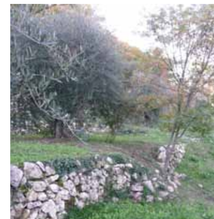
Terrasses dégradées – « raccourci » au droit de l'arbre. Ginger strategis.
