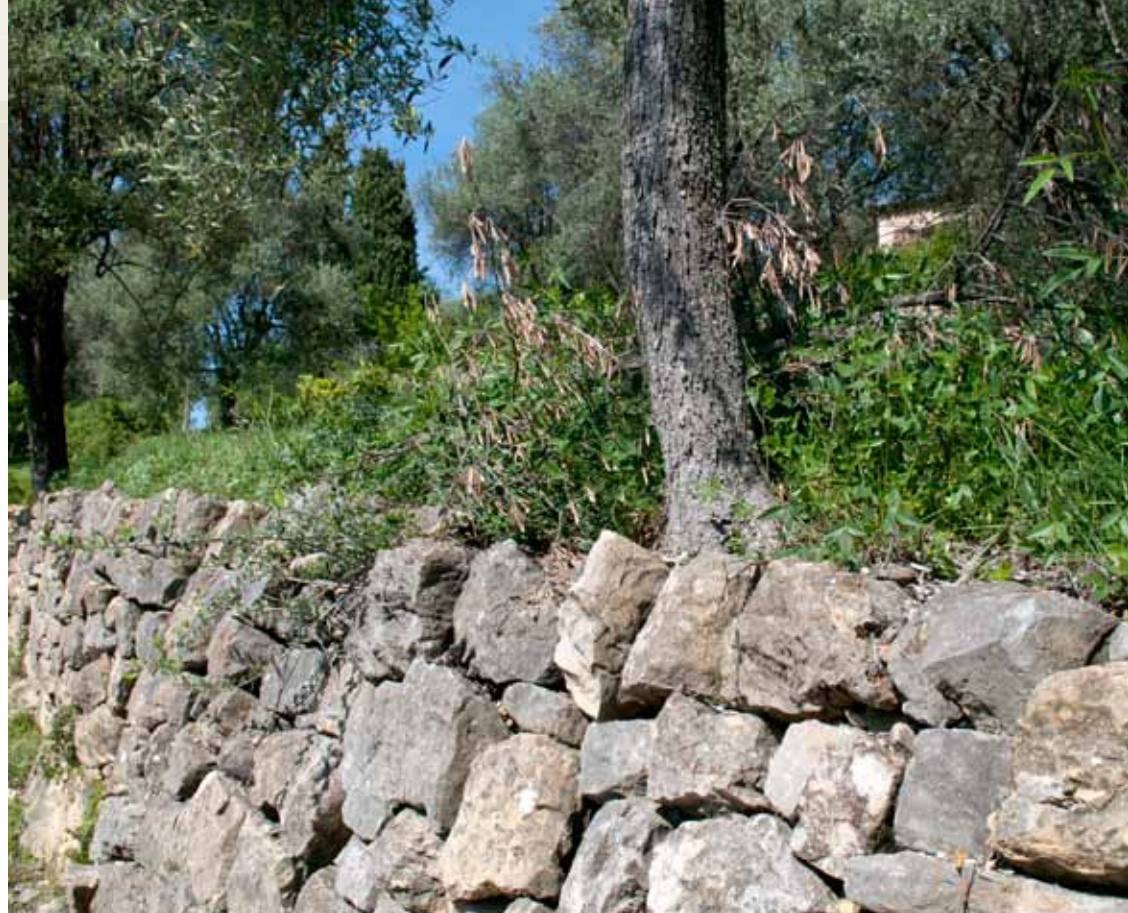
Oliviers plantés en bordure de mur : leurs racines risquent de l'endommager, Opio. David Vincendeau, CASA.
